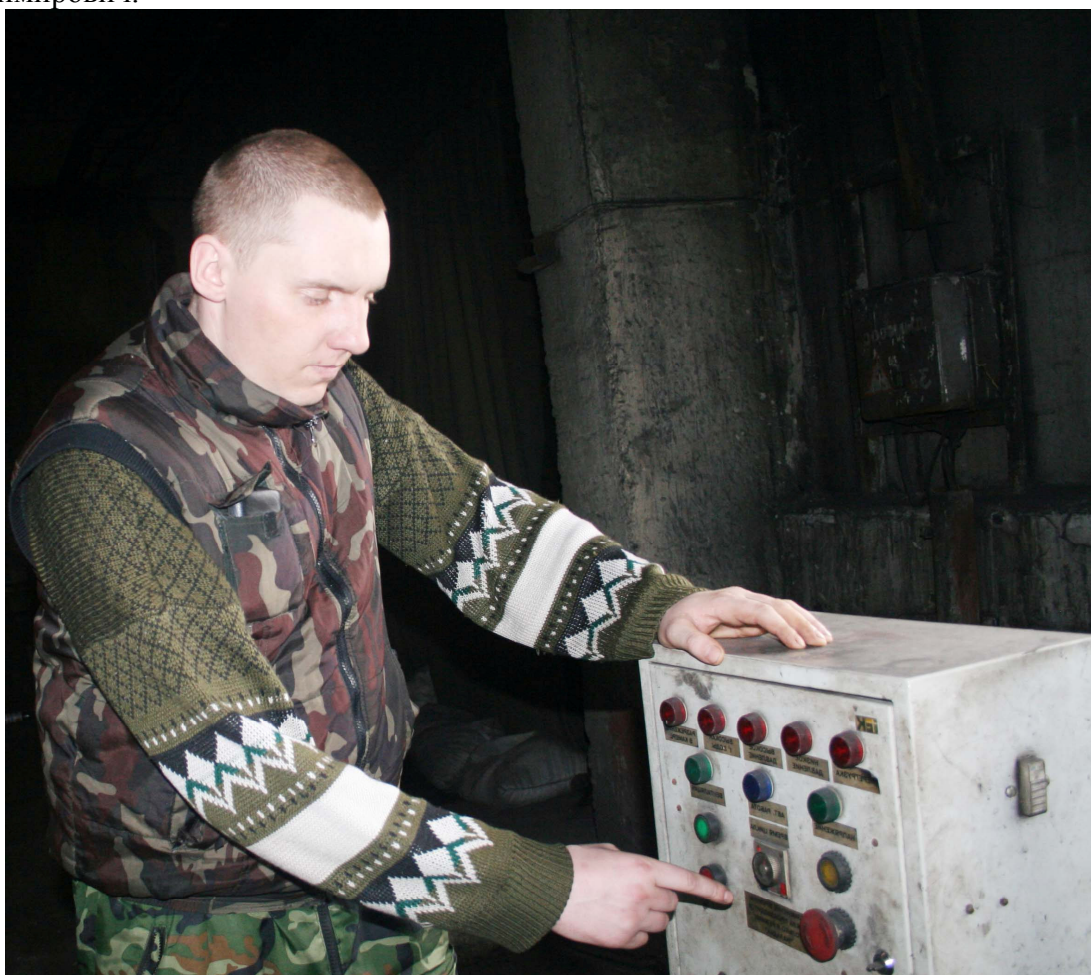
Андрей Мальцев хорошо знаком с электронным пультом управления котельной – более восьми лет работает электромонтером в жилищно-коммунальном хозяйстве.
